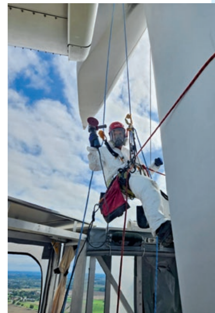
Bei Windrädern ab 100 Metern Höhe kommen mobile Arbeitsbühnen zum Einsatz. Alle Arbeitsgeräte, wie der Schleifer, sind an Seilen gesichert.
